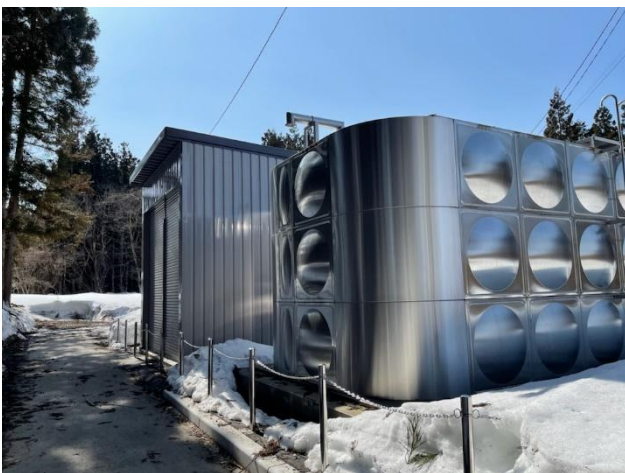
▲大登飲料水供給施設（大登浄水場）
