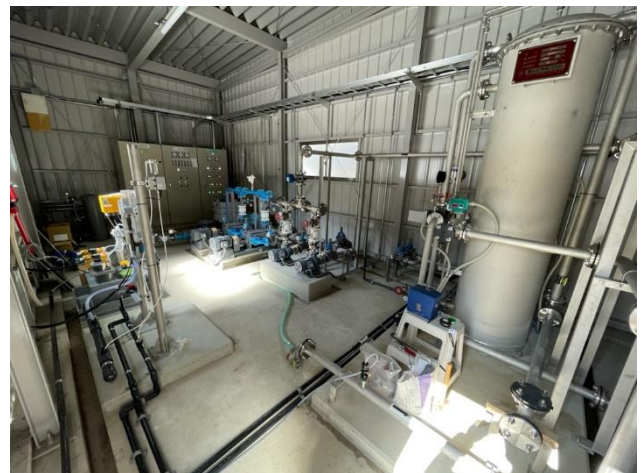
▲大登飲料水供給施設（浄水場内部）
