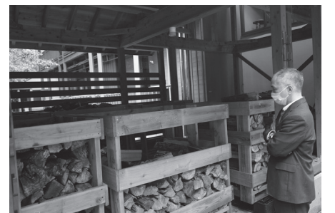
▲工芸館の薪ボイラーを見学
