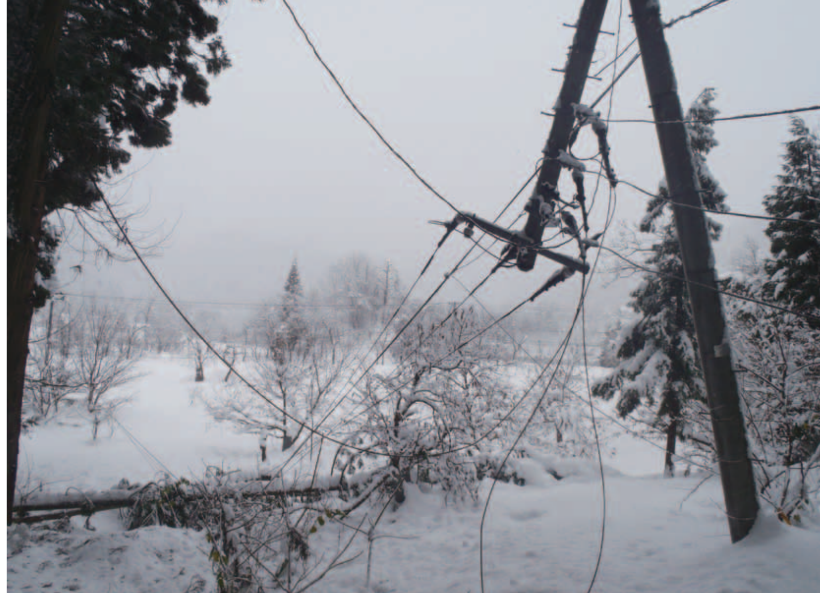
雪の影響で折れた電柱（小和瀬）
