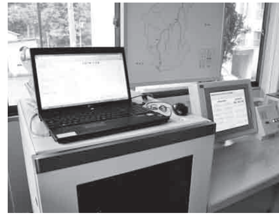
今年度から新しくなった防災無線設備。画面左側が全国瞬時警報システム
