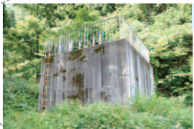
浅岐配水池 容量 48m 3 【給水地域】 浅岐地区
