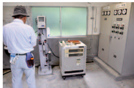
送水ポンプと塩素注入施設
