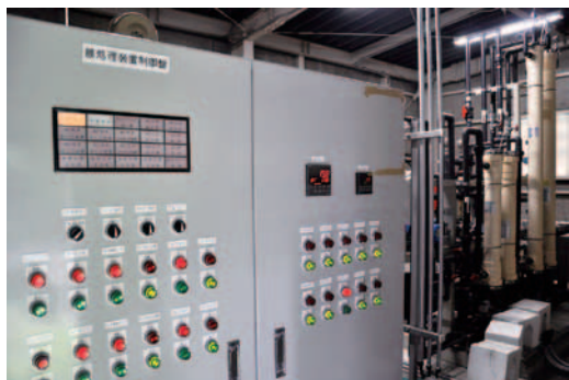
滝谷浄水場の膜処理設備
