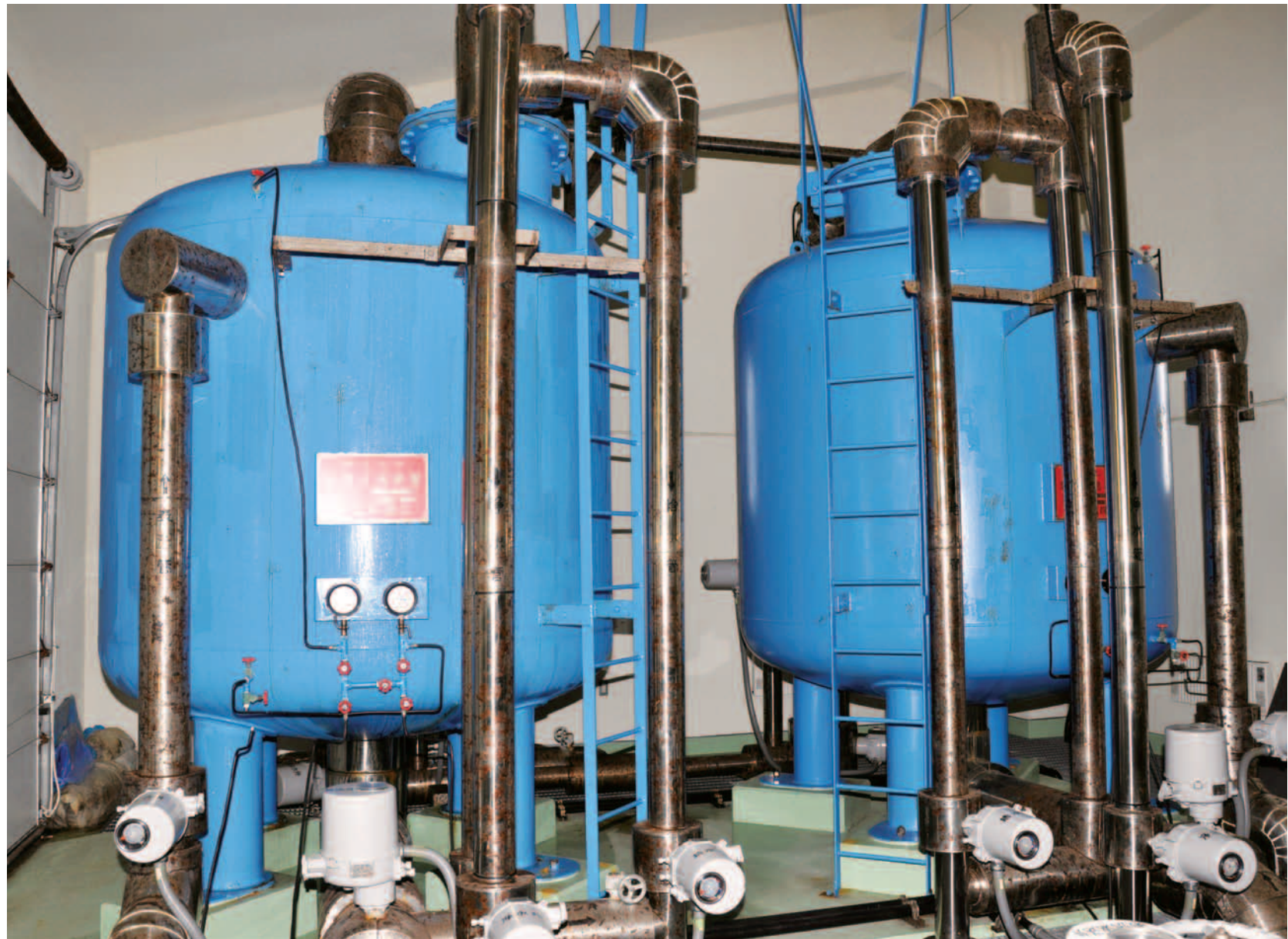
大谷浄水場の急速ろ過機
