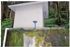
早戸湯ノ上配水池 容量 32m 3 【給水地域】 早戸地区
