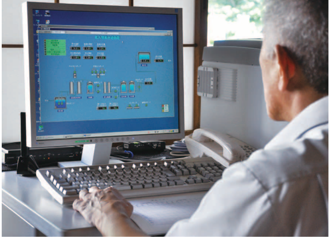
すべての水道施設の水量や水質を24時間監視している水道管理システムの画面
