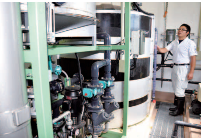
名入浄水場の活性炭処理・膜処理設備
