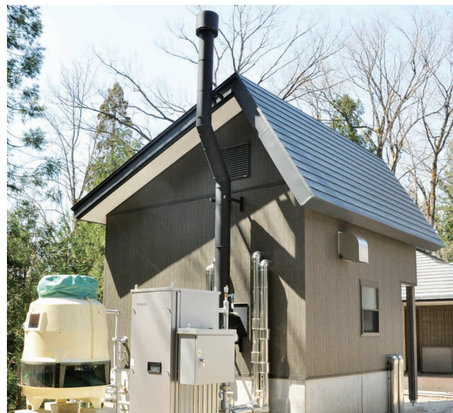
生活工芸館裏に建設された薪ボイラー冷暖房施設
