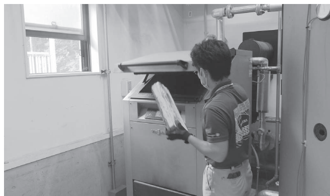
ボイラーに薪をくべる二瓶館長
