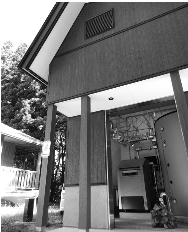
生活工芸館に設置された薪ボイラー施設
