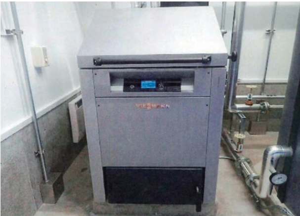
▲ 三島町生活工芸館の薪ボイラー
