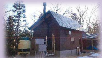
木の駅事業と連携した薪ボイラーの利用（2018年～）
